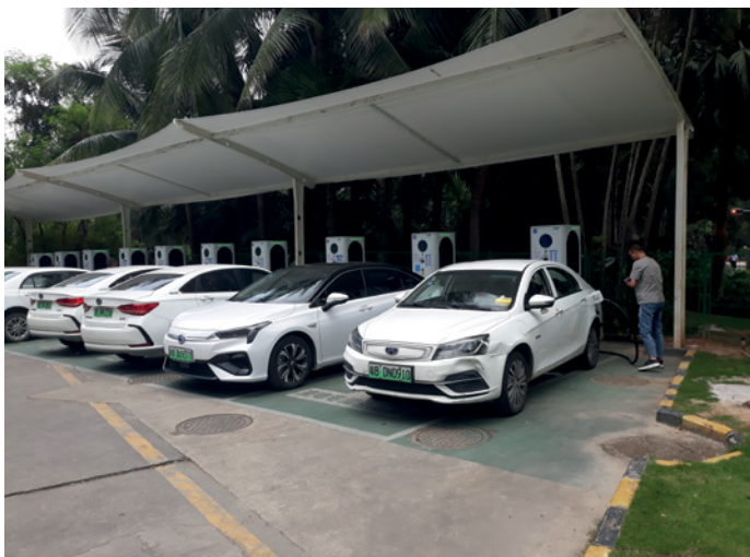
Abb. 1 Kleinere Ladestation mit 10 Schnellladesäulen auf Hotelparkplatz © E-MetropoLIS, Thomas Prill
